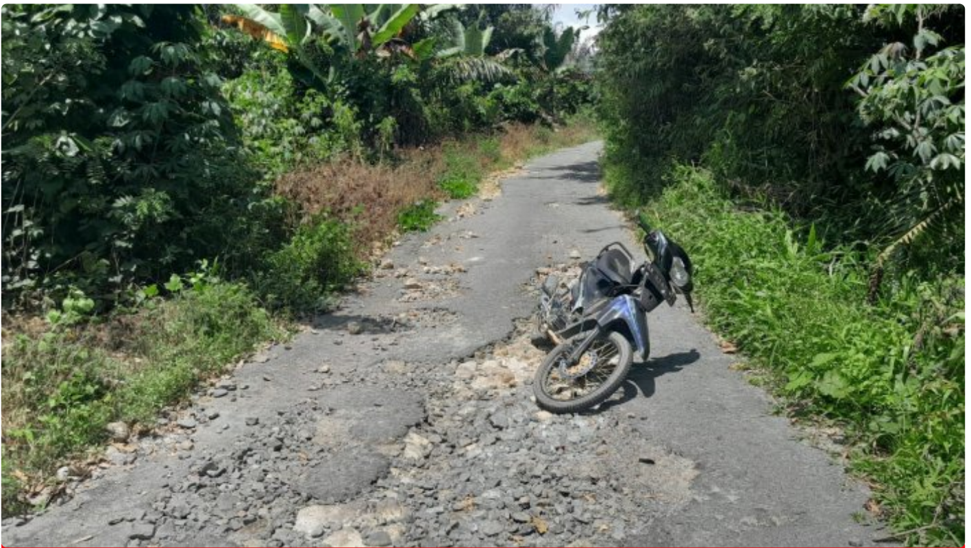
Ruas jalan jurusan Kandang Lombu-Hutaurung, Nagori Panombean Hutaurung, Kecamatan Jorlanghataran, Kabupaten Simalungun sudah rusak
